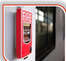
أجهزة أنذار الحريق Fire Alarm System
